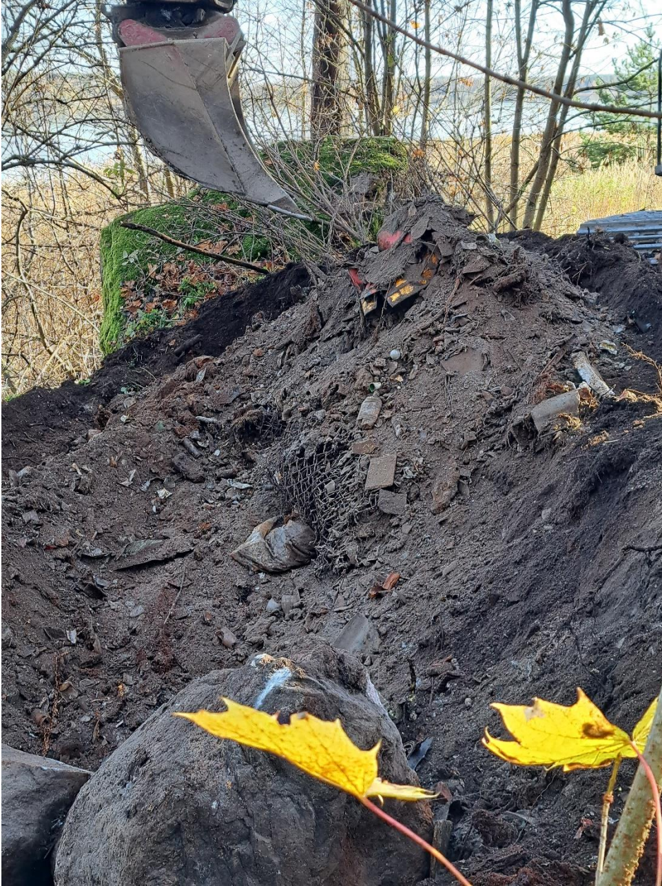
Kuva 6 Bitumitynnnyreiden vieressä olevia jätteitä
