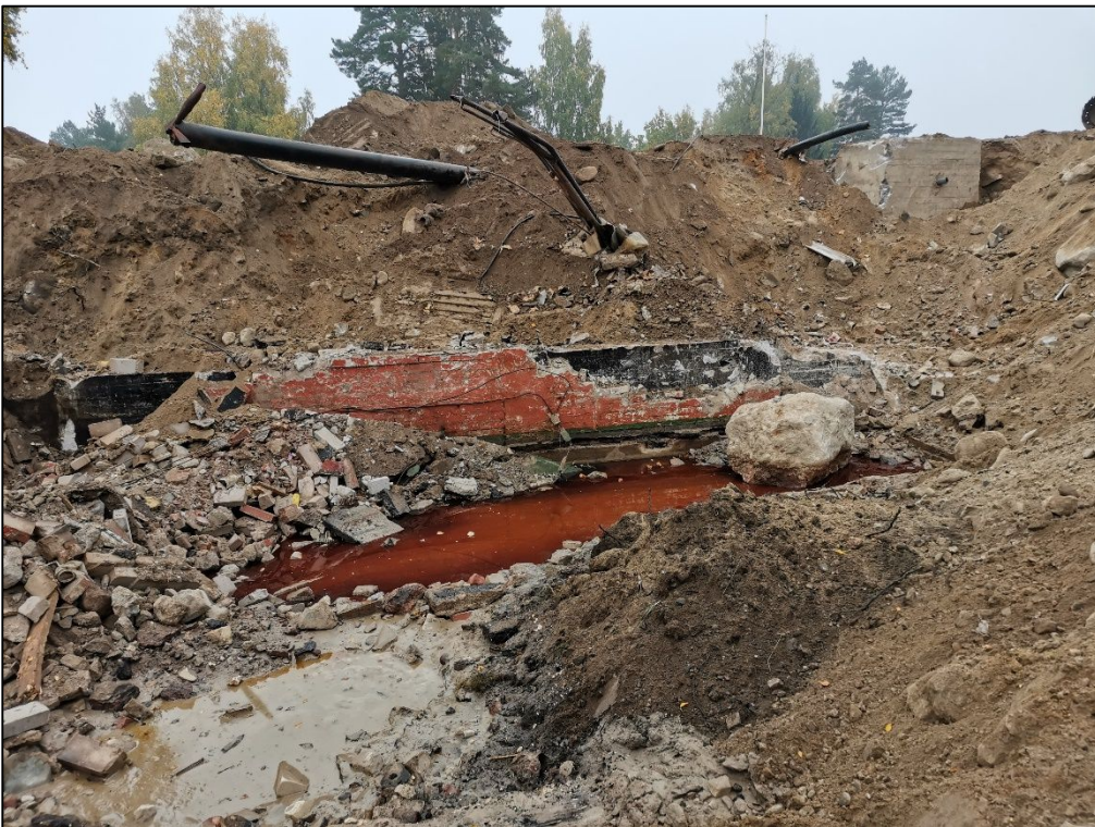
Kuva 4. Öljyä kerääntyi kallion päälle, öljy poistettiin imuautolla.
