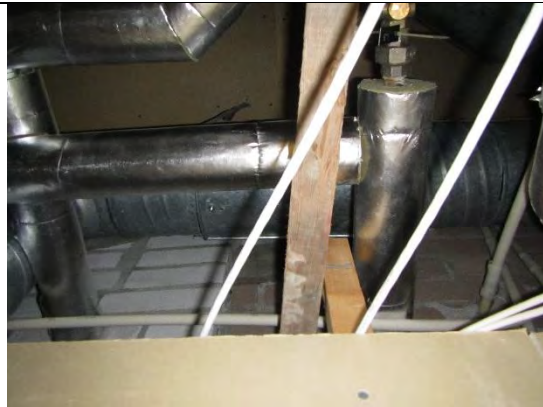
Kuva 47. Alaslaskettujen kattojen päällä havaittiin mineraalivillalla eristettyjä vesiputkia.
