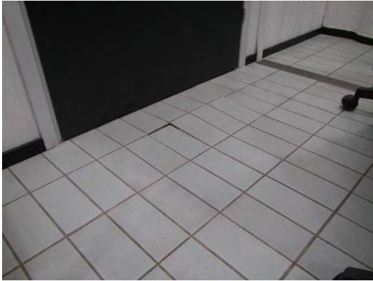
Kuva 9. Lattialaatat olivat irti alustastaan kirjastossa 1022.
