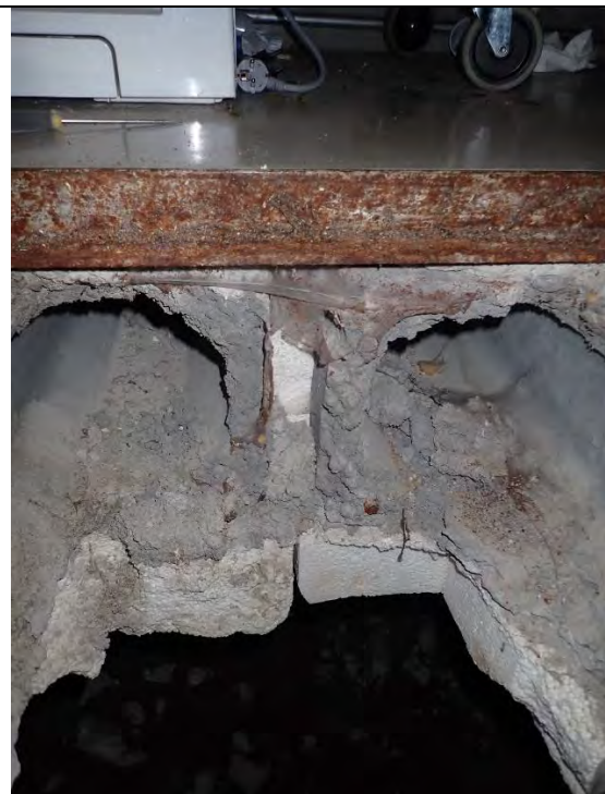
Kuva 8. Ontelolaatan onteloiden rajapinta kuvattuna tilan 1059 lattialuukusta.
