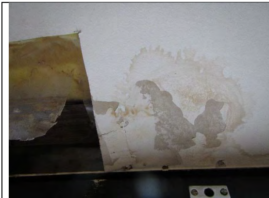
Kuva 68. Tilan 1067 (RA12) yläpohjan rakennusmateriaalit olivat vaurioituneet kosteuden vaikutuksesta.
