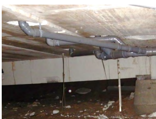
Kuva 80. Muoviviemäriä havaittiin alapohjatilassa.
