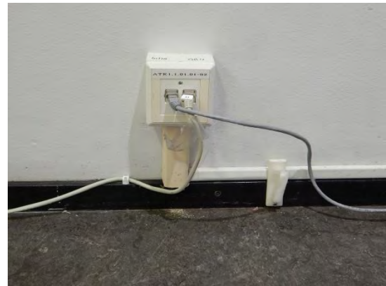
Kuva 89. Tietoliikennesasia asennettu lista-asennuksena.
