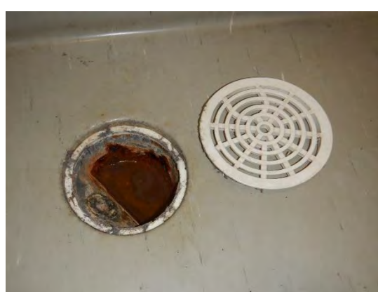
Kuva 81. Alkuperäinen lattiakaivo oli valurautaa.
