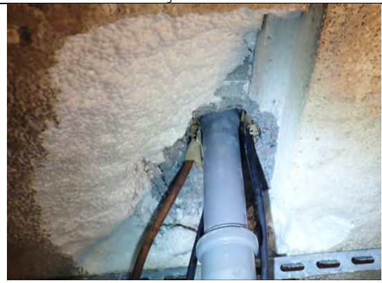
Kuva 21. Alapohjan putkiläpivientejä ei oltu tiivistetty.
