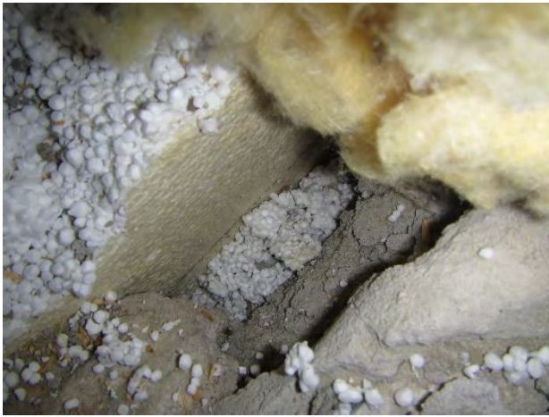
Kuva 13. Sokkelissa havaittiin EPS-lämmöneristeen ja harkkomuurauksen välissä ilmarako
