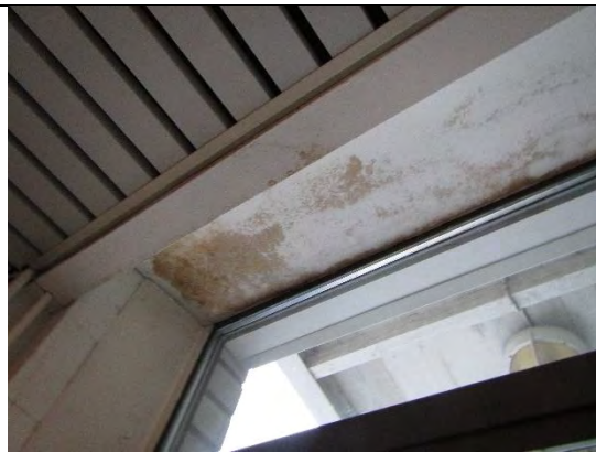
Kuva 65. Tuulikaapin 1001 katon kipsilevyssä havaittiin kosteusjälkeä.
