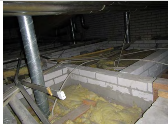
Kuva 54. Kiinteiden alakattojen päällä havaittiin pinnoittamatonta mineraalivillaa ja rakennusjätettä.
