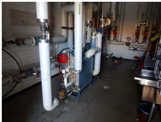
Kuva 74. Yleiskuva kaukolämmön alajakokeskuksesta.
