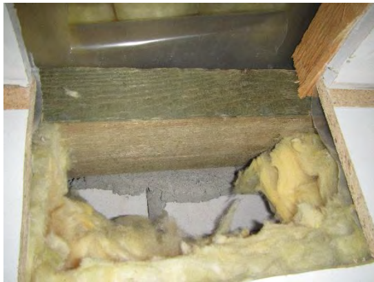
Kuva 30. Kuva poikkeavasta levyrakenteesta ulkoseinästä, RA4, tila 1094.
