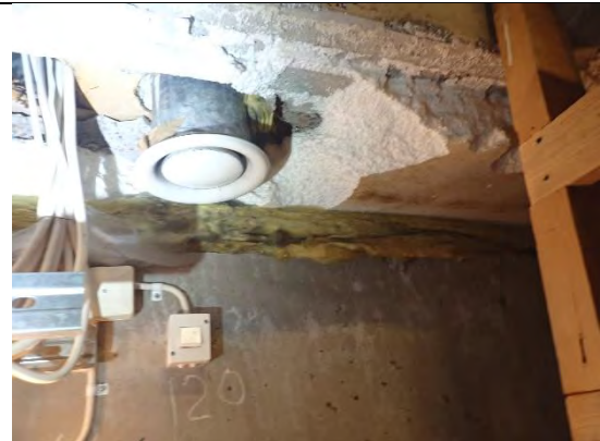
Kuva 15. Tekniikkatilan tuloilmakanava. Kanavan läpivienti ei ole tiivis. Tekniikkatilan seinän ja alapohjan välissä oli mineraalivillakaista, joka oli tummunut.
