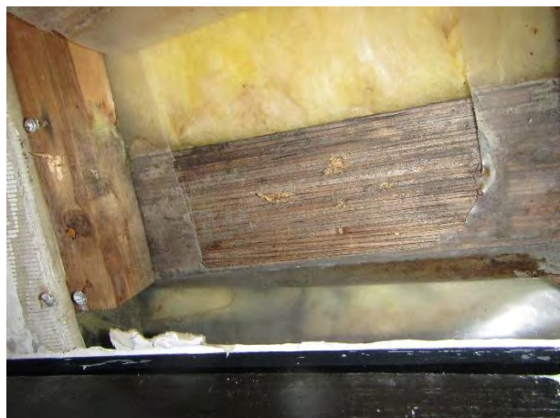
Kuva 25. Valokuva vaurioituneista puurakenteista.
