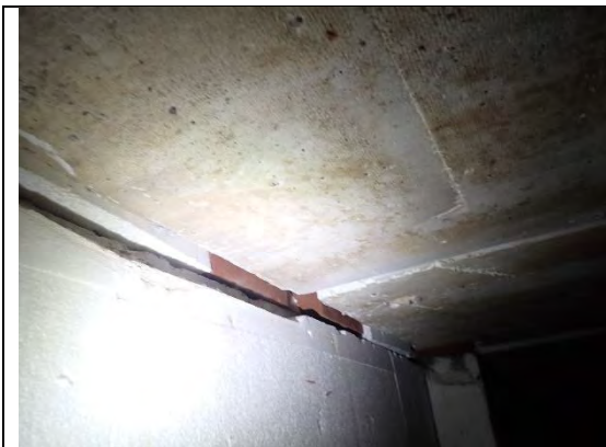
Kuva 22. Alapohjan ontelolaattojen asennuksessa oli käytetty tiiliä asennuskiiloina.
