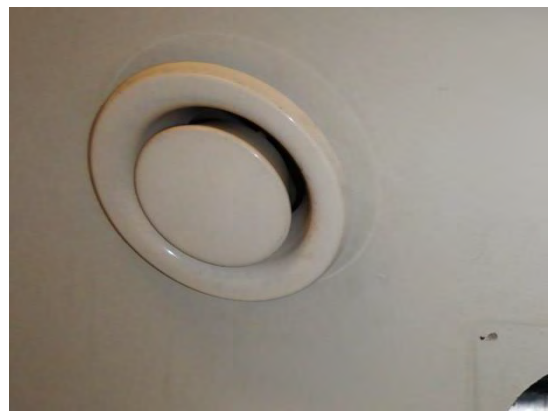
Kuva 83. Ilmanvaihdon pääte-elimet oli puhdistettu kanavanuohouksen yhteydessä.
