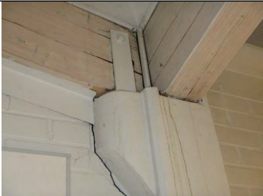
Kuva 72. Liimapuupalkkien liittymissä havaittiin useita halkeamia ja vesivuotojälkiä (kuva tilasta 1089)
