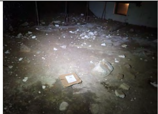
Kuva 17. Alapohjatilassa havaittiin rakennusjätettä, josta pieni osa oli orgaanista.
