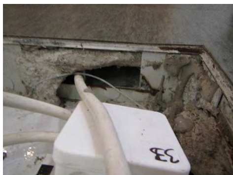
Kuva 7. Kirjaston 1102 lattiarasiat oli upotettu ja sähköjohdot roilottu pintavaluun.
