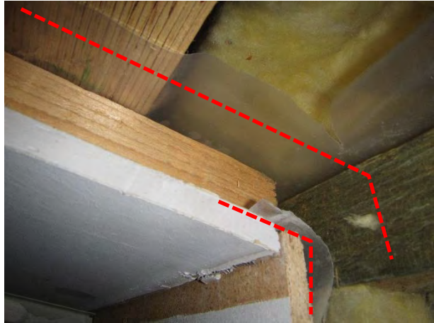
Kuva 8. Valokuva rakenneavauksesta, yläpohjan ja ulkoseinän höyrynsulkumuovit eivät limity.
