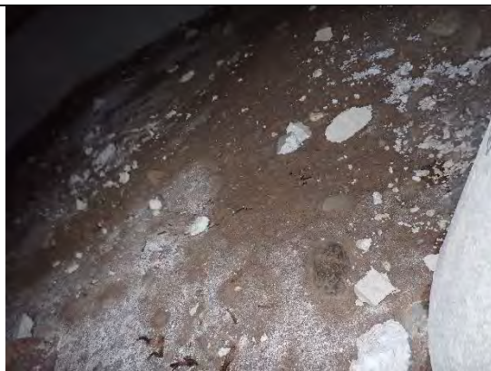
Kuva 18. Maaperässä salaojakaivon ympärillä oli näkyvää mikrobikasvustoa.
