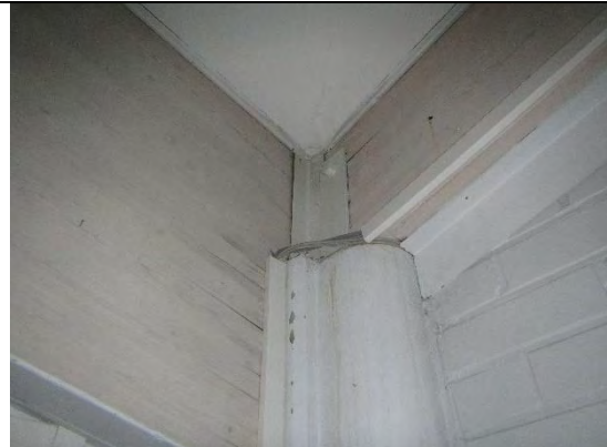
Kuva 73. Liimapuupalkkien liittymissä havaittiin useita halkeamia ja vuotojälkiä (kuva tilasta 1109).
