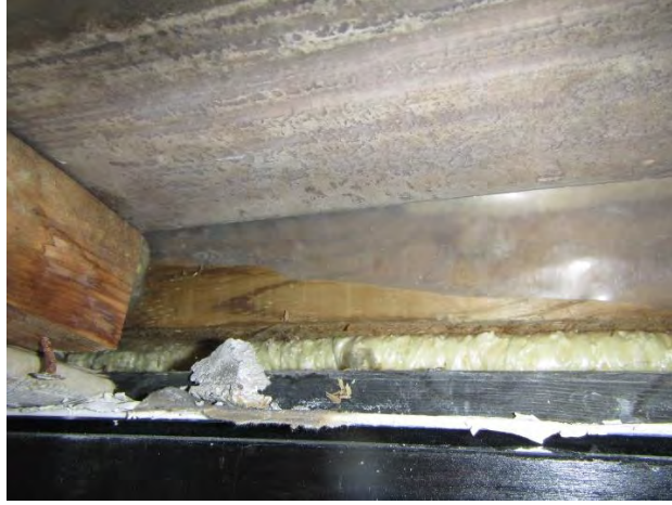
Kuva 26. Höyrynsulkumuovi roikkui ulkoseinän apukarmin sisäpuolella ja sen yläpinnalla havaittiin mikrobikasvua.
