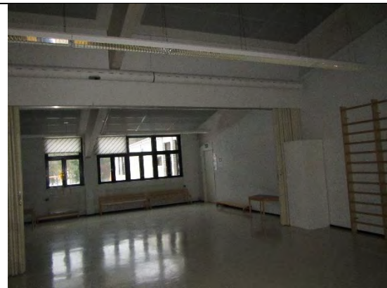
Kuva 66. Kuntoutustilan 1087 lattialla havaittiin kohonnutta kosteutta.
