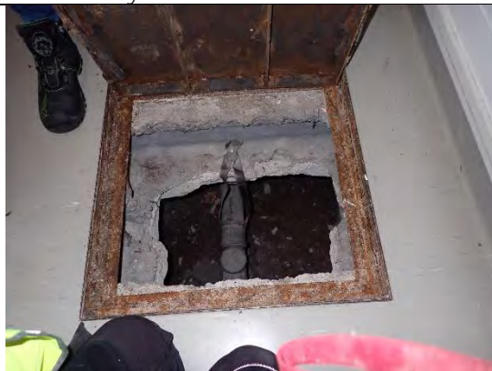
Kuva 20. Alapohjassa oli huoltoluukkuja, jotka eivät olleet tiiviitä.
