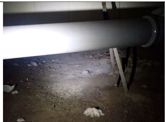
Kuva 23. Alapohjassa oli jälkiä veden lamikoitumisesta. Alapohjassa olevat putket oli kannakoitu ontelolaattojen saumoihin asennetuilla teräspannoilla.
