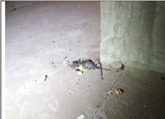
Kuva 16. Tekniikkatilassa havaittiin kuollut lintu.
