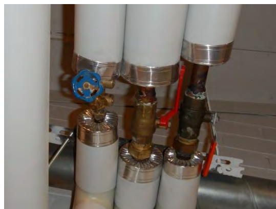
Kuva 79. Alkuperäiset sulku ja linjasäätöventtiilit.
