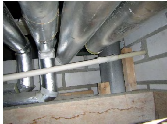
Kuva 48. Osassa vesiputkien lämmöneristeitä oli teipattu, osassa ei ollut. Puurakenteessa havaittiin vanhaa kosteusjälkeä.
