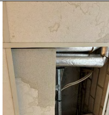
Kuva 52. Käytävän 1085 alakattolevyissä havaittiin kosteusjälkiä.
