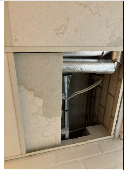
Kuva 64. Käytävän 1085 alakattolevyissä havaittiin kosteusjälkiä.
