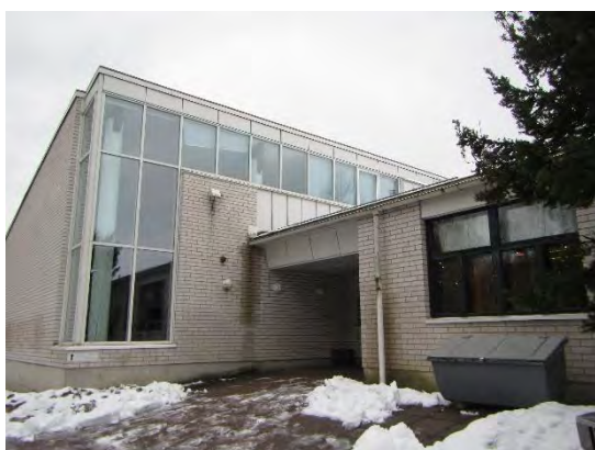
Kuva 32. Kerhotilan 1024 ulkopuolen kosteusrasitusta lisäävät toimimattomat katon syöksytorvet.
