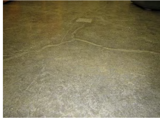
Kuva 10. Lattian pintalaatassa havaittiin useita halkeamia tilassa 1093.
