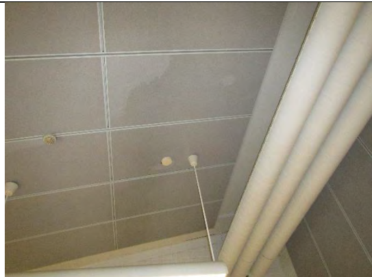
Kuva 51. Katon akustolevyt olivat tummuneet tuloilmavirtauksista johtuen (kuva tilasta 1089).
