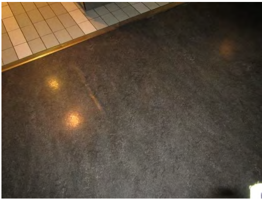
Kuva 11. Lattian pintalaatassa havaittiin useita halkeamia tilassa 1035.
