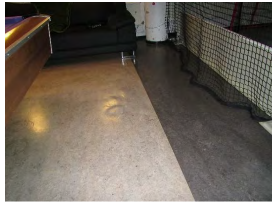
Kuva 12. Lattian pintalaatassa havaittiin useita halkeamia ja linoleumissa kohoumia tilassa 1038.
