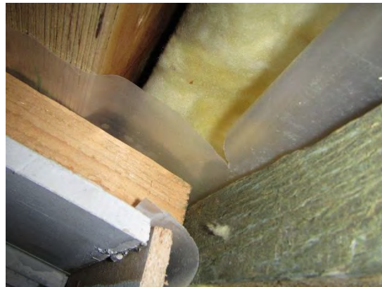
Kuva 31. Ulkoseinän höyrinsulkumuovi ei limity yläpohjan höyrinsulkumuovin kanssa.
