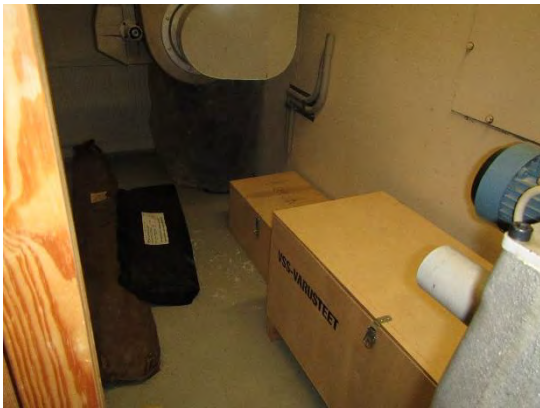
Kuva 13. Väestönsuojan lattiamaali hilseilee.
