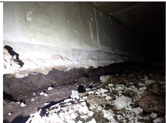
Kuva 19. Maaperä oli painunut pohjoispuoleisella ulkoseinälinjalla.
