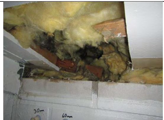
Kuva 69. Tilan 1052 (RA14) yläpohjarakenteessa ei havaittu höyrynsulkumuovia, eikä kertopuupalkkia, rakenteen vaurioitunut.
