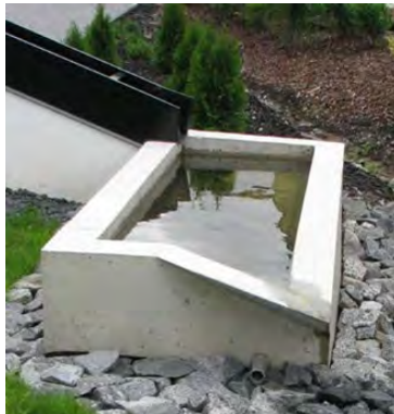
Kuva 17. Hulevesien keräämiseen varattu rakenteellinen allas.
